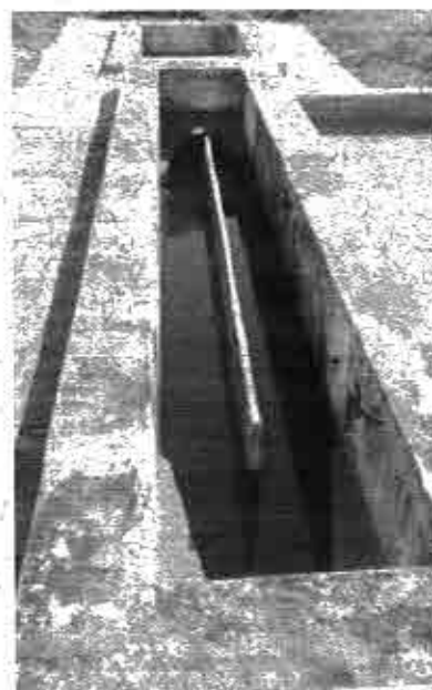
Foto 3.10 – Caixa de Areia
